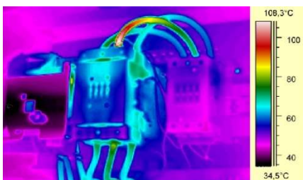
Erkennbarer, defekter Kabelanschluss
